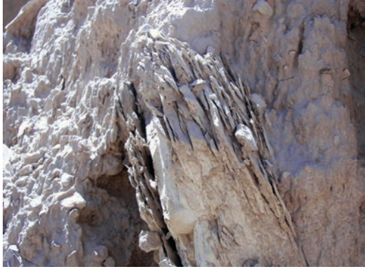
الصورة رقم (٣٩). التفتت السطحي لأحجار البناء.
